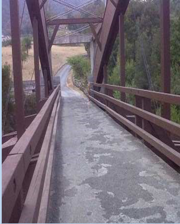
Brücke im Tal zwischen Laino und Papisidero (Kalabrien), wo der Fluss Lao fließt.
